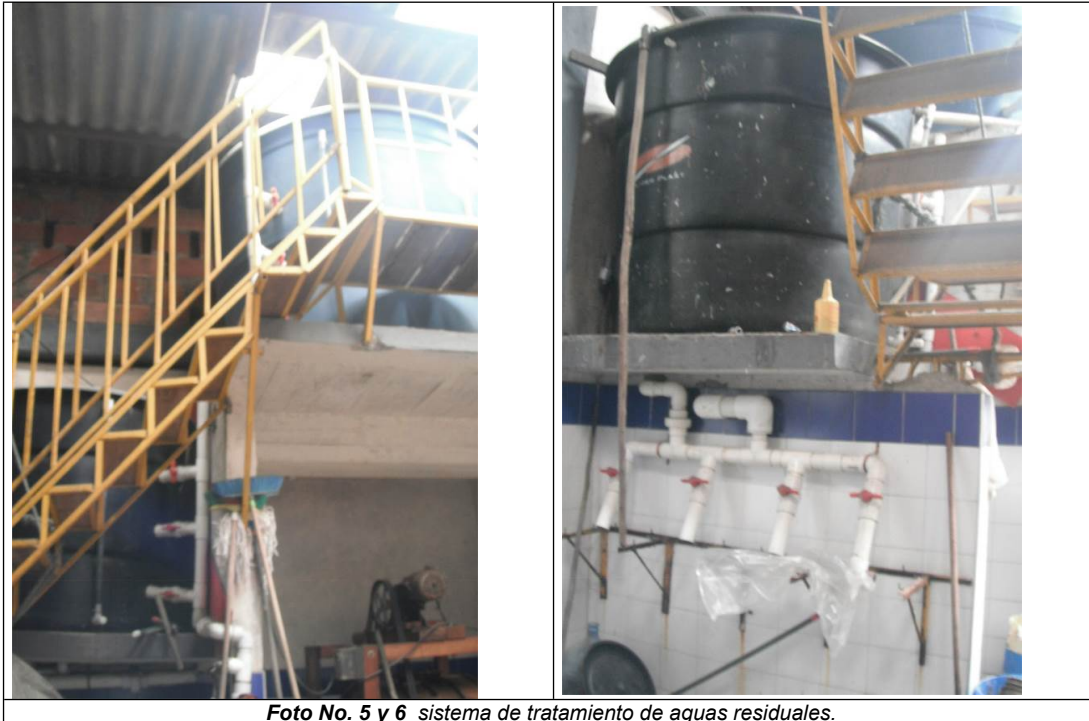
Foto No. 5 y 6 sistema de tratamiento de aguas residuales.
